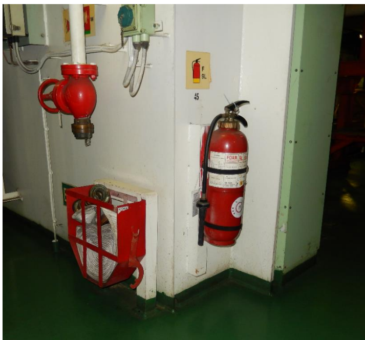
Slika 37: Protipožarna oprema v strojnici
